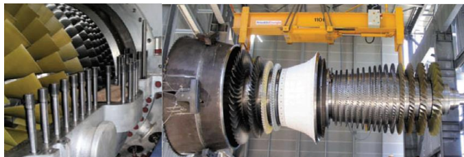
Turbina a gas ciclo combinato RPW 2°GT
