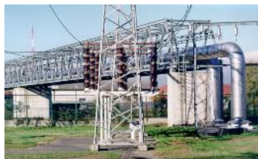
Tubazioni teleriscaldamento in uscita dalla Centrale.
