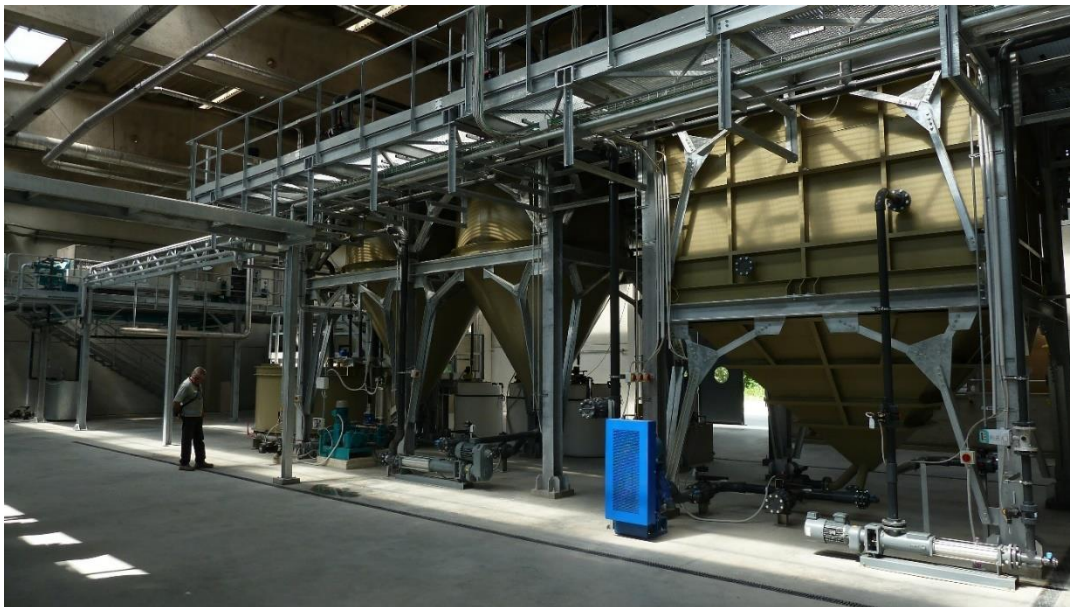
Figura 9 – Vista dell'impianto di trattamento chimico-fisico dei rifiuti liquidi
