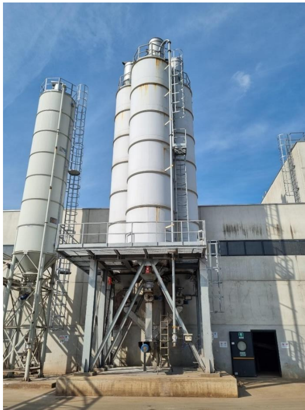
Figura 8 – Silos stoccaggio rifiuti in polvere
