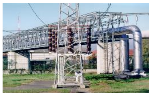
Tubazioni teleriscaldamento in uscita dalla Centrale.
