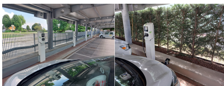
Foto obiettivo 5: efficienza energetica, corpi illuminati a tecnologia LED
